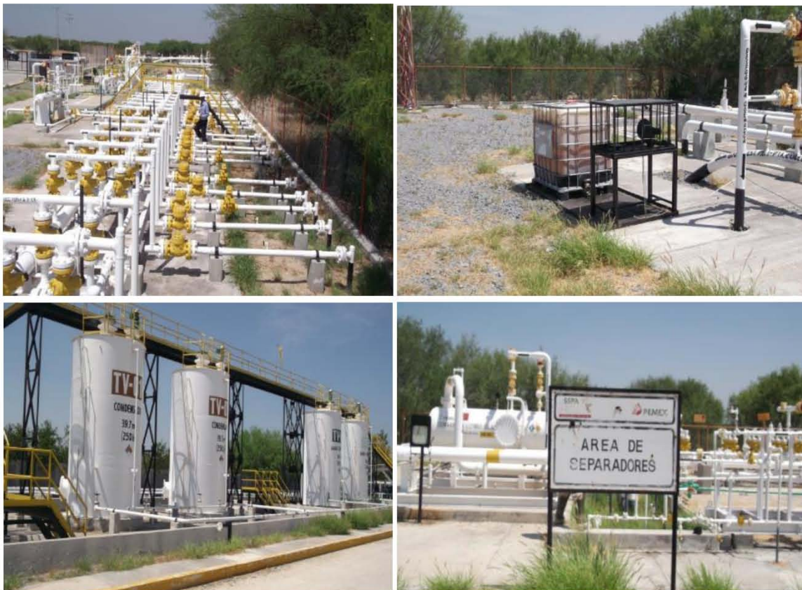
Figura 8.4-26.- Recorrido en la Estación de Recolección de Gas Peña Blanca 1.
