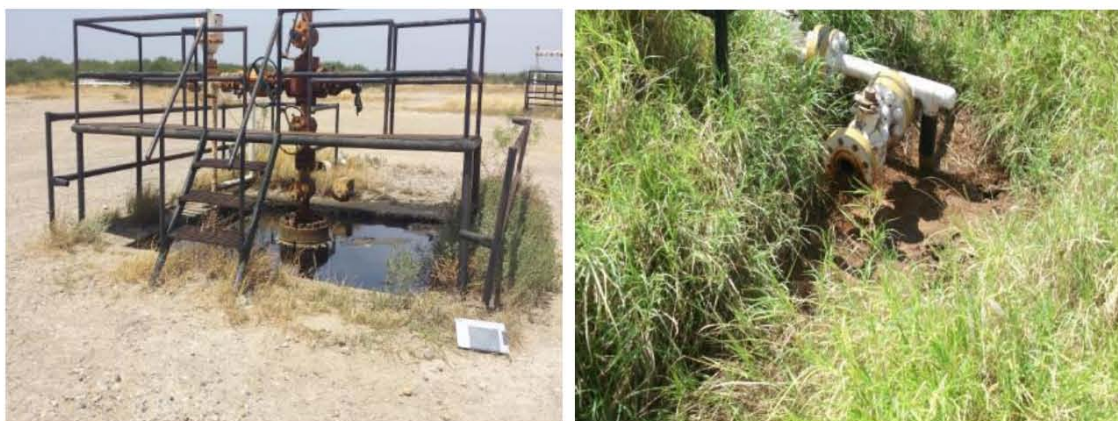
Figura 8.4-23.- Acumulación de agua por precipitaciones en el contrapozo del pozo PB129 (izquierda) y al pozo PB135 (derecha) Pozo sin presencia de contrapozo.
