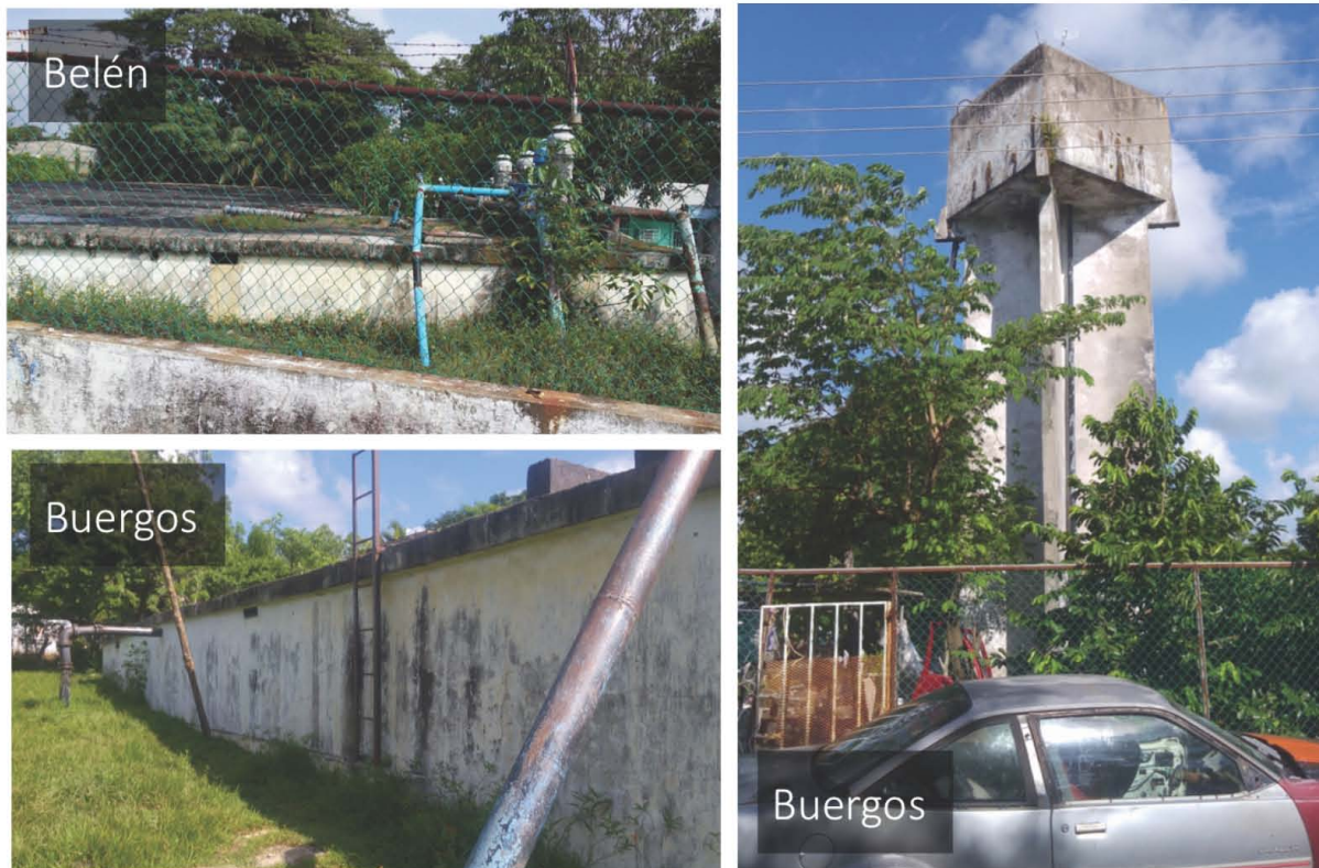
Figura VII.1.1.23. Pilas y Tanques de Almacenamiento de Agua.
