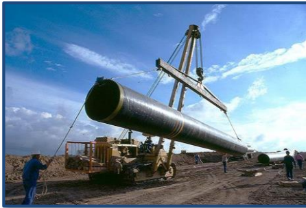
Empresa de gasoductos (México)
