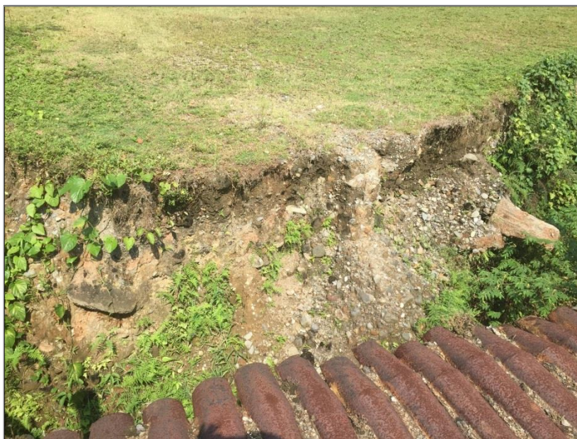
Imagen 2b.10.- Puente principal de acceso a la macropera, se encuentra sin conexión al siguiente extremo debido a la erosión de la tierra y por debilitación del cabezal del extremo posterior.
