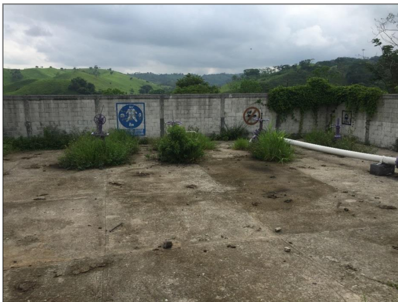
Imagen II.b-23.- Líneas de descarga de los pozos de 6" \varnothing y conexión al cabezal del múltiple de producción general y de medición (Macropera Catedral 1).
