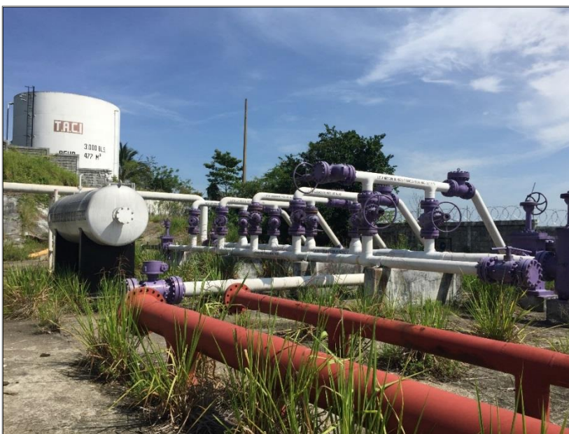
Imagen II.b-25.- Vista del cabezal de producción general de 12" y de medición de 8" Catedral 1
