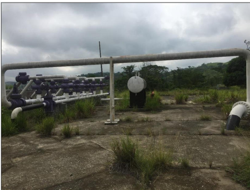
Imagen II.b-24.- Vista general en mal estado del Oleogasoducto de 8" a la Batería de Separación Muspac.
