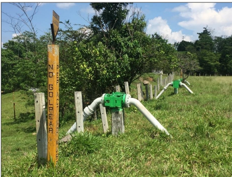
Imagen II.b-19.- Válvulas de seccionamiento en mal estado de la Macropera Catedral 15
