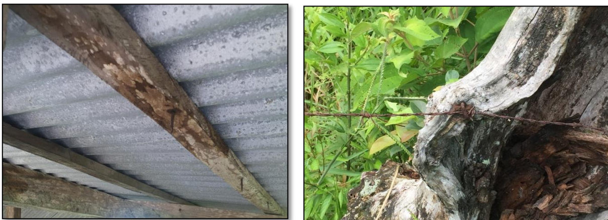
Imagen II.g-36. -Daños en láminas, clavos y cercas según vecinos del área contractual catedral.
