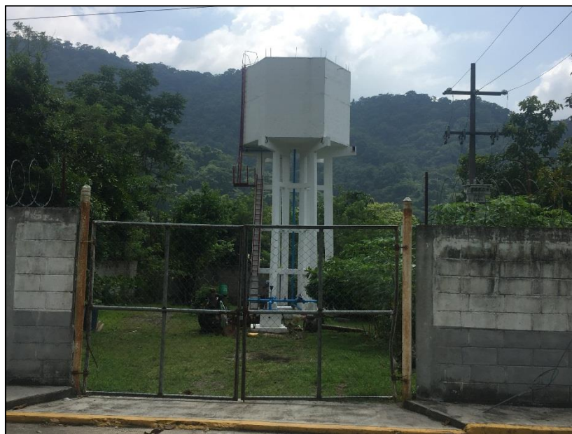
Imagen III.e-5. - Pozo de agua profundo.
