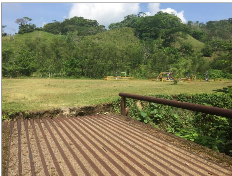
Imagen 2b.9.- Puente principal de acceso a la Macropera Catedral 75, presenta corrosión severa generalizada y sin conexión al siguiente extremo.
