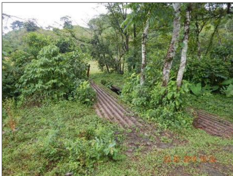
Imagen 2b.11.- Acceso peatonal por puente tubular con falta de mantenimiento a la Macropera Catedral 75.
