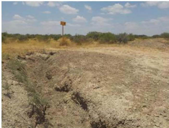
Figura 30 Presencia de surcos cerca del Camino a Carretas 303.
