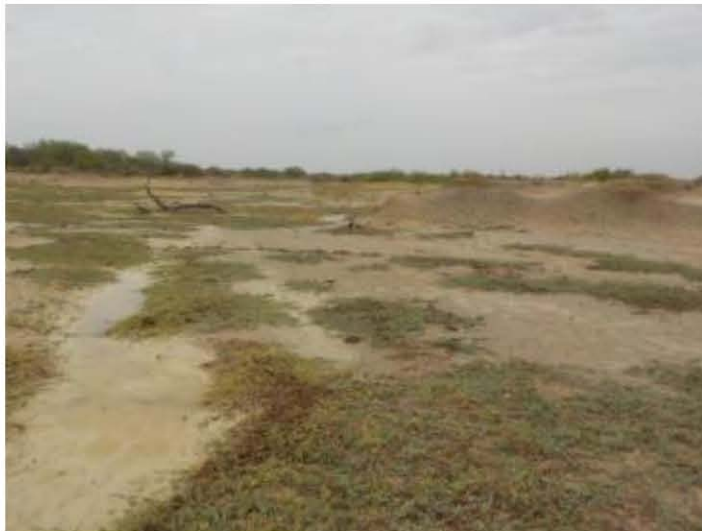
Figura 33. Detalle de una represa con el bordo roto (a) y la erosión que provocó (b).
