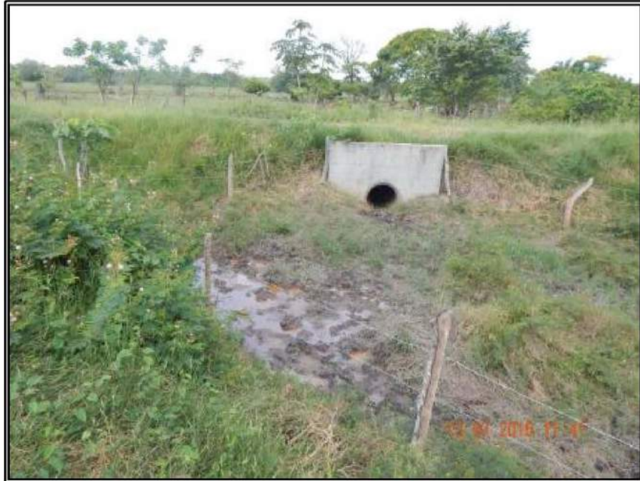
Fotografía 3.- Drenaje en la periferia del cuadro de maniobras del pozo Calicanto101, en las coordenadas UTM WGS 84 X: 0424184, Y: 1978010.
