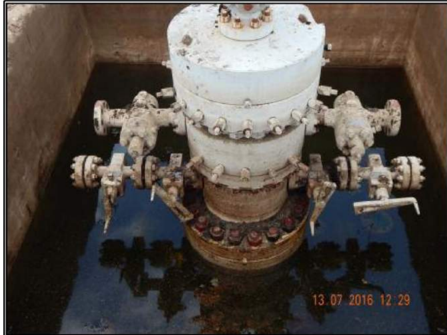
Fotografía 35.- Falta de volantes de la primera sección de la tubería de revestimiento.
