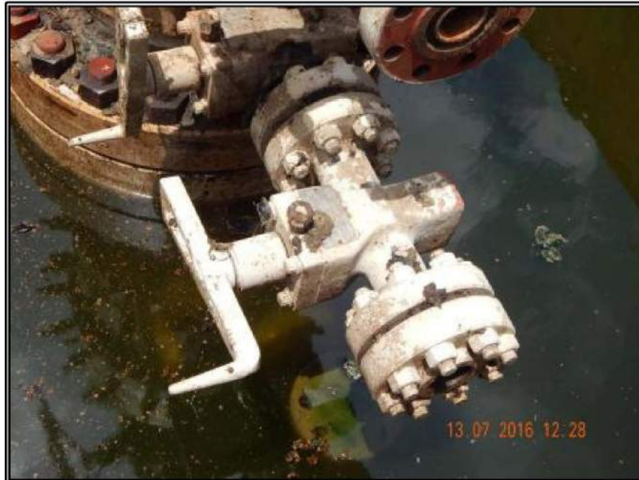
Fotografía 33.- Falta de tapón roscado en brida de reducción de la segunda sección de la tubería de revestimiento derecha.
