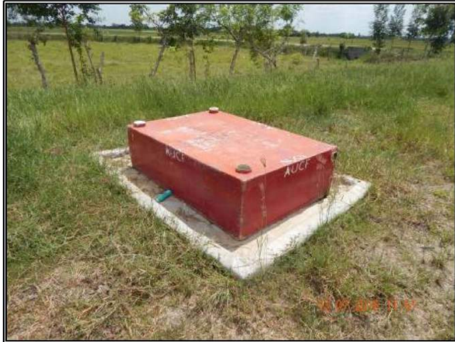
Fotografía 7.- Fosa séptica abandonada dentro del cuadro de maniobras del pozo Calicanto 101. En las coordenadas UTM WGS 84 X: 0424261, Y: 1978011.
