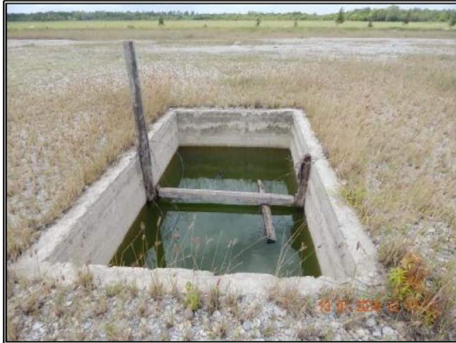
Fotografía 19.- Condición insegura, contrapozo sin barandales e inundado al 50% (Posible Calicanto 102) dentro del cuadro de maniobras del pozo calicanto 101. En las coordenadas UTM WGS 84 X: 424266, Y: 1977980.
