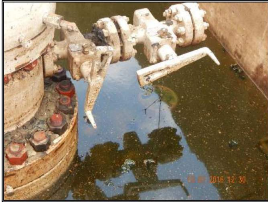
Fotografía 36.- Posible tercera sección de la tubería de revestimiento inundada.
