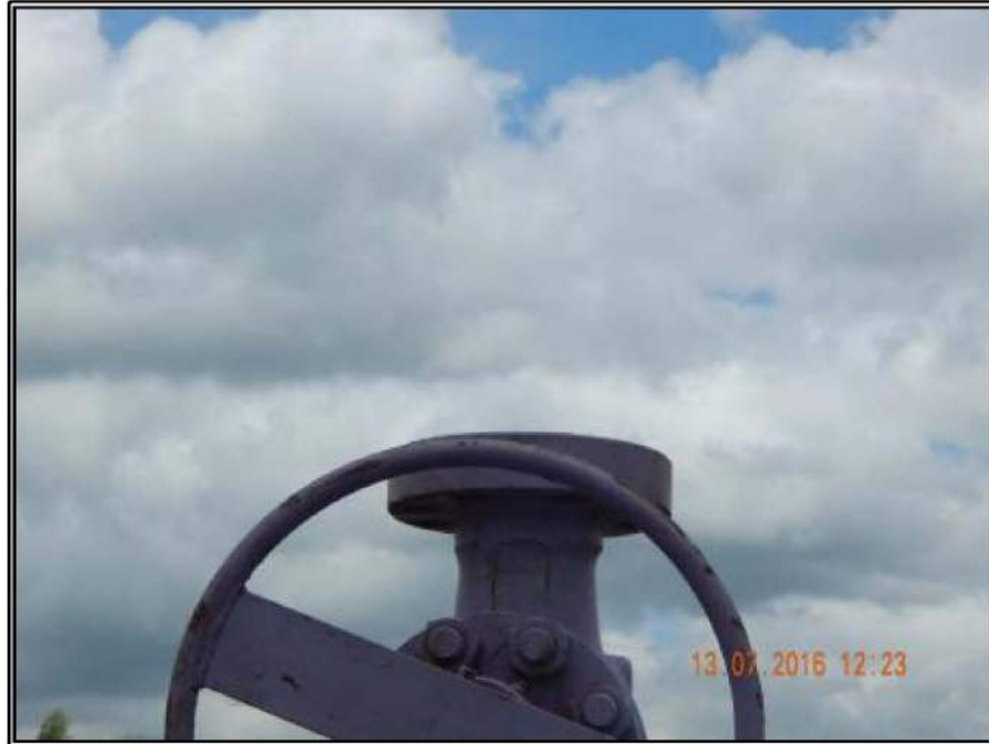
Fotografía 24.- Falta de brida de sondeo y capuchón.
