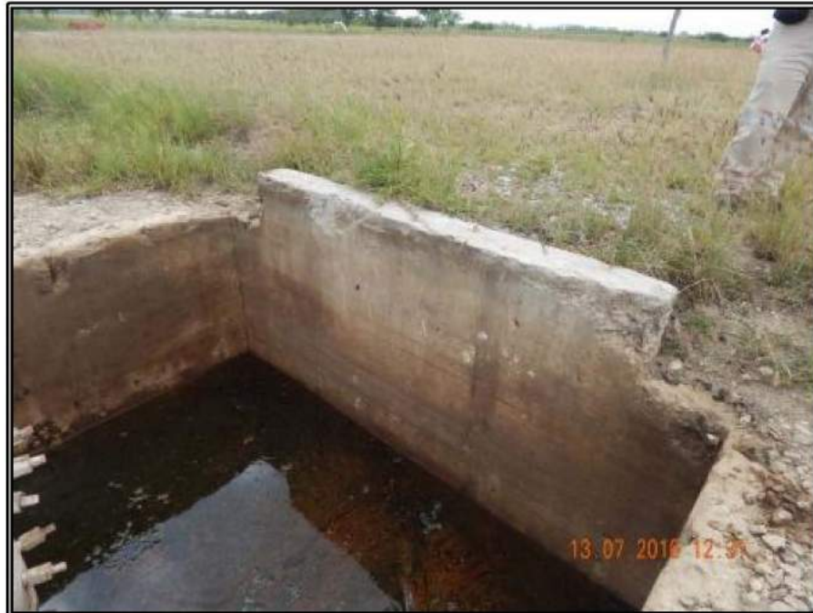
Fotografía 38.- Falta de rejilla tipo Irving, contrapozo dañado y presencia de hidrocarburo en el agua.
