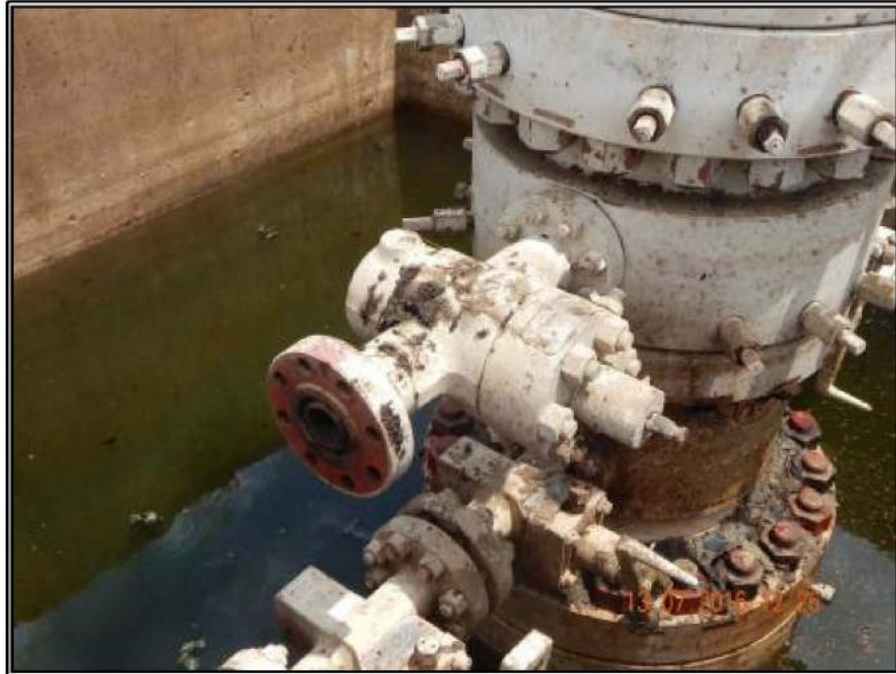
Fotografía 30.- Falta de brida ciega en válvula lateral izquierda de la primera sección de la tubería de revestimiento.
