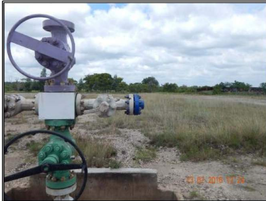
Fotografía 25.- Falta de válvula lateral externa de trabajo y volante de válvula lateral interna de trabajo dañado.
