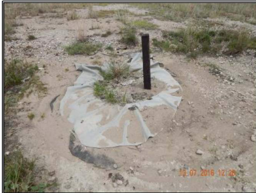
Fotografía 22.- Posible salida de Línea de Descarga (Pozo a limite de instalación) dentro del cuadro de maniobras del pozo Calicanto 101. En las coordenadas UTM WGS 84 X: 0424240, Y: 1977977.
