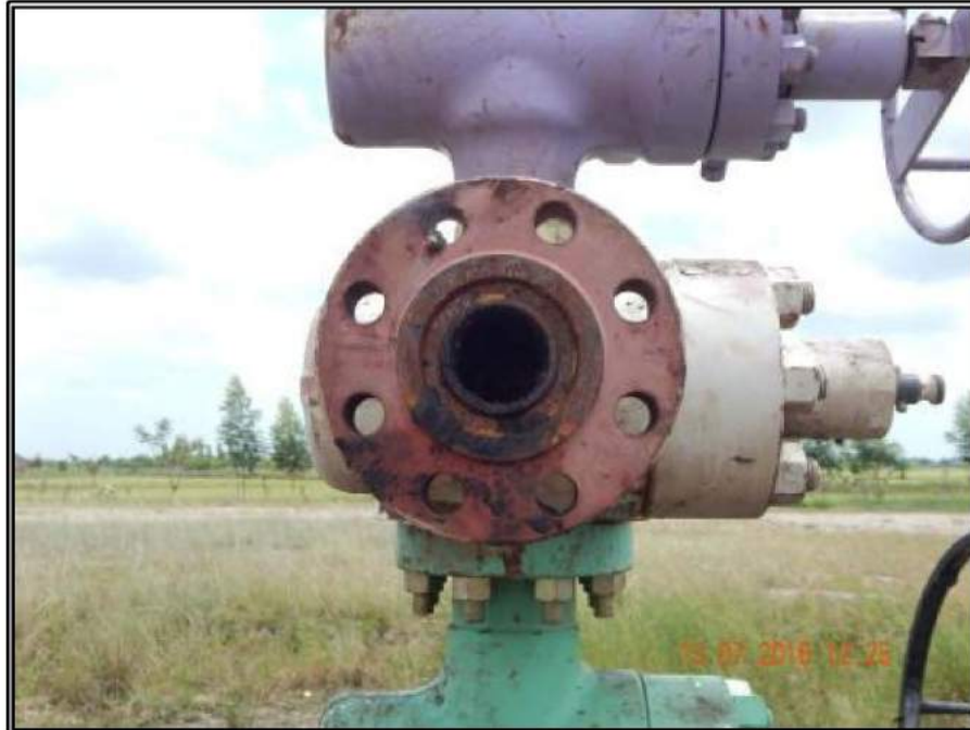
Fotografía 28.- Árbol de válvulas con manchas de hidrocarburo (Indicadores de reciente trabajo de pozo).
