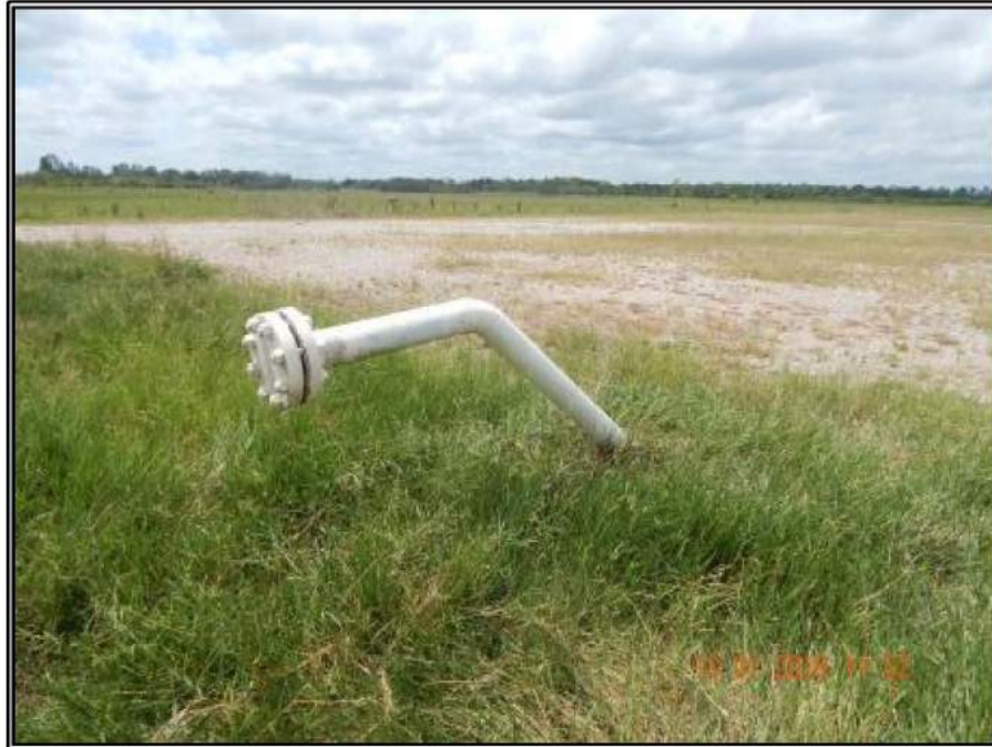
Fotografía 8.- Preparación de línea de descarga dentro del cuadro de maniobras del pozo Calicanto 101, cuenta con brida ciega. En las coordenadas UTM WGS 84 X: 0424282, Y: 1978010.
