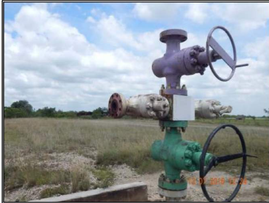
Fotografía 27.- Falta de válvula lateral externa de descarga, brida ciega y volante en válvula lateral interna de descarga.
