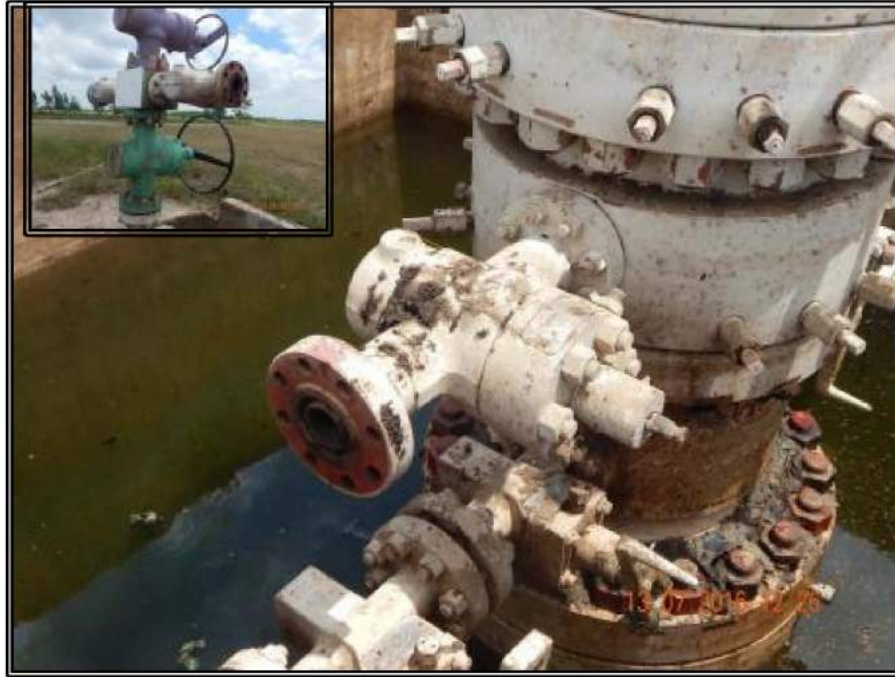
Fotografía 29.- Árbol de válvulas con corrosión y manchas de hidrocarburo.
