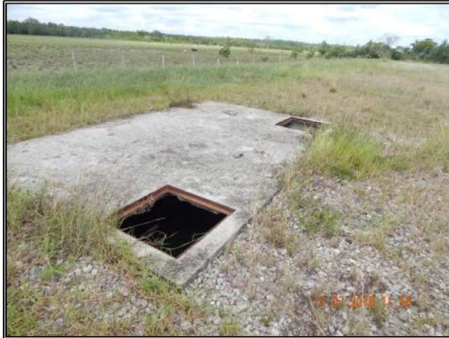
Fotografía 10.- Condición insegura dentro del cuadro de maniobras del pozo Calicanto 101 (Posible fosa sin tapas). En las coordenadas UTM WGS 84 X: 424298, Y: 1977940.
