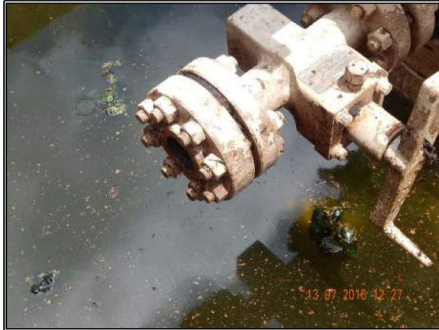
Fotografía 31.- Falta de tapón roscado en brida de reducción de la segunda sección de la tubería de revestimiento izquierda.
