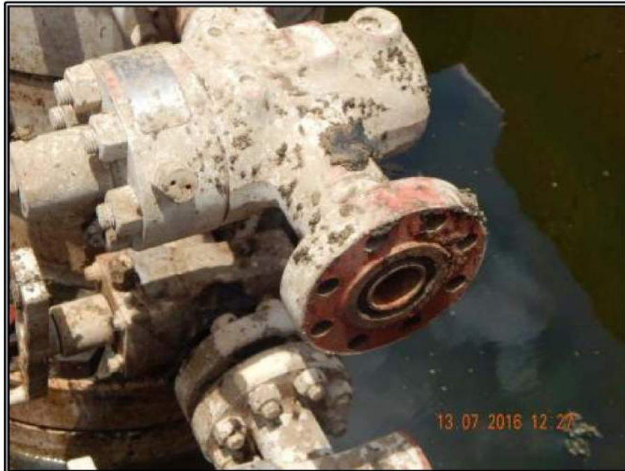
Fotografía 32.- Falta de brida ciega en válvula lateral derecha de la primera sección de la tubería de revestimiento.
