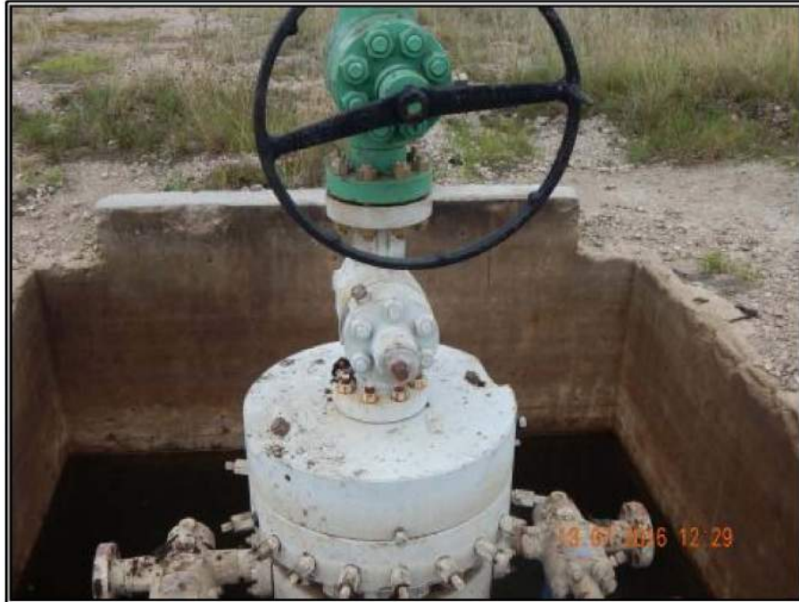
Fotografía 34.- Falta de volante en válvula maestra.
