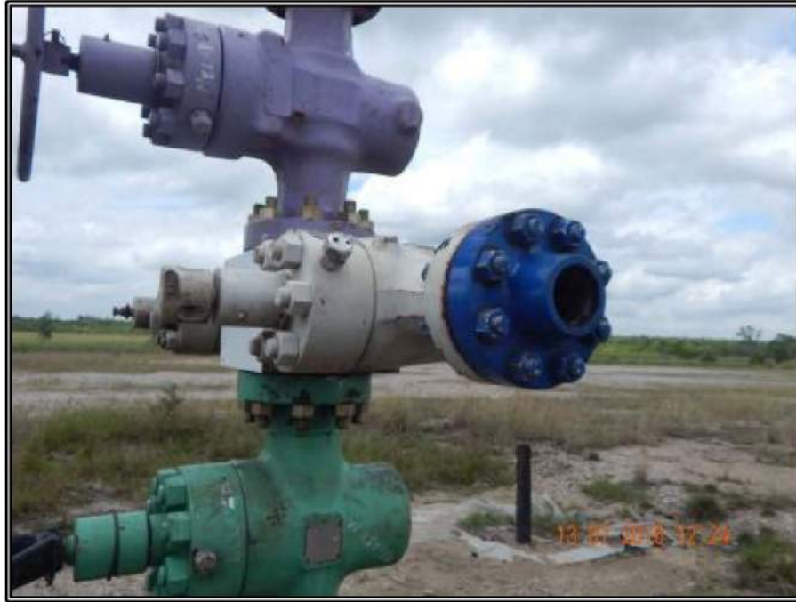
Fotografía 26.- Falta de tapón roscado en brida de reducción lateral de trabajo.
