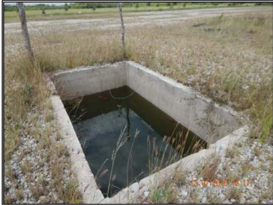
Fotografía 20.- Condición insegura, contrapozo sin barandales e inundado al 50% (Posible Calicanto 103) dentro del cuadro de maniobras del pozo Calicanto 101. En las coordenadas UTM WGS 84 X: 424255, Y: 1977983.
