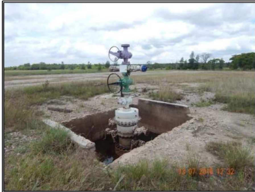
Fotografía 39.- Falta barandal de contrapozo.
