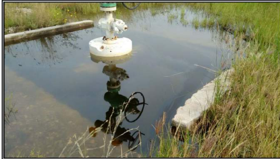
Fotografía 8.4.1-13.- Contrapozo donde se encuentra el pozo Calicanto 101 inundado.
