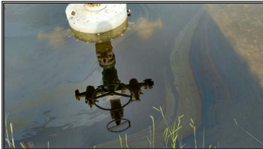
Fotografía 8.4.1-14.- Indicio de hidrocarburo en la superficie del agua presente en el contrapozo del pozo Calicanto 101 (iridiscencia).
