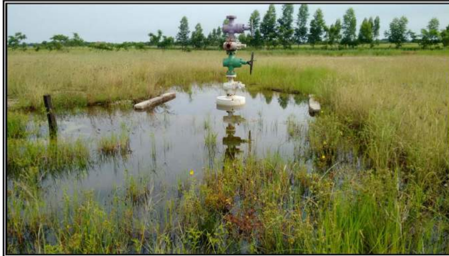
Fotografía 8.4.1-15.- Presencia de agua en la superficie del terraplén del pozo Calicanto 101.
