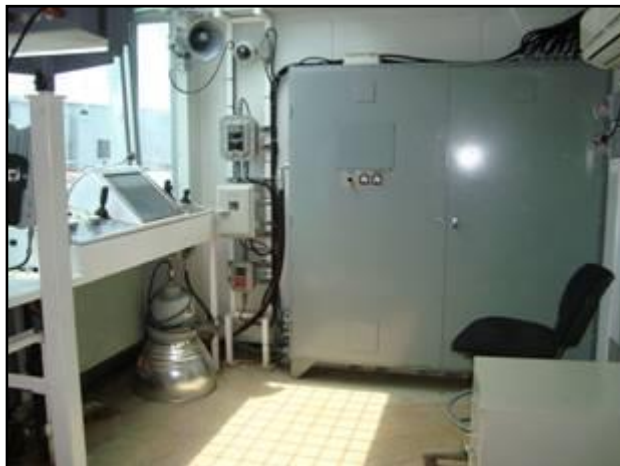
Imagen 1.3.1.1 cuarto de control remoto ( Dog House ) equipo de perforación.
