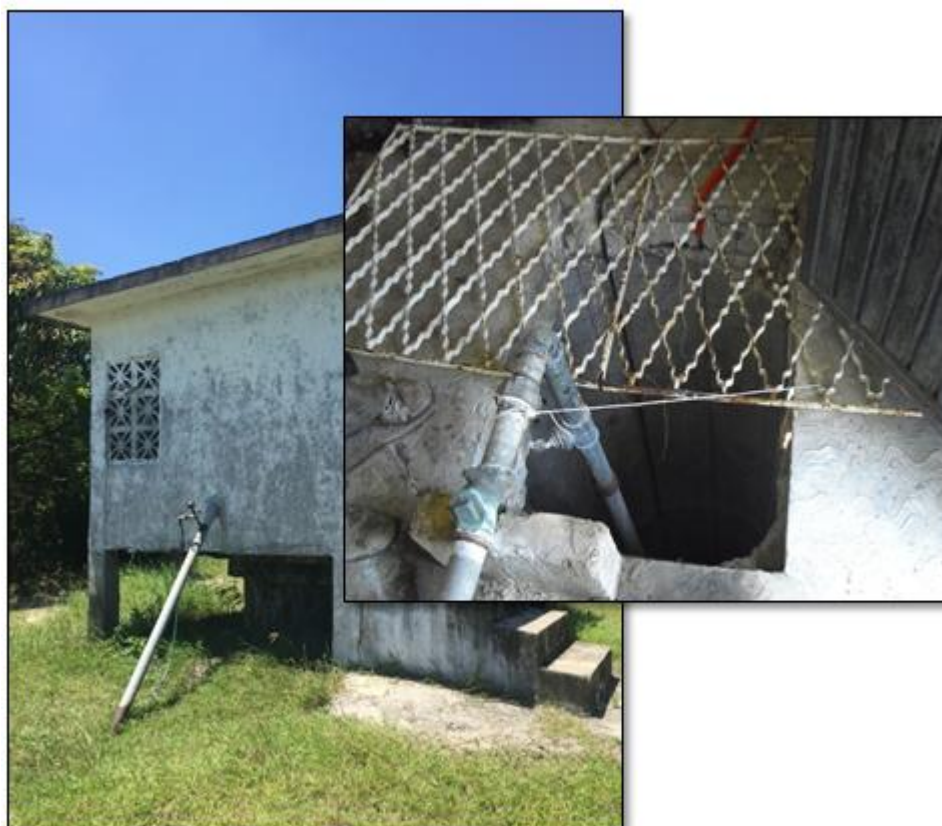
Imagen III.a-5.- Sistema de abastecimiento de agua en el Ejido Agua de Castilla (22°31'44 N / 97°57'37 O).
