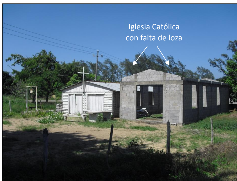
Imagen III.a-8.- Iglesia sin techo (22°31'40 N / 97°57'08 O).
