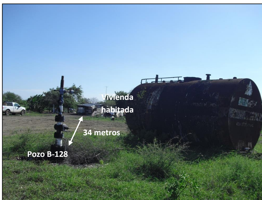
Imagen II.g-11.- Instalación cercana a vivienda en Rancho El Guajolote.
