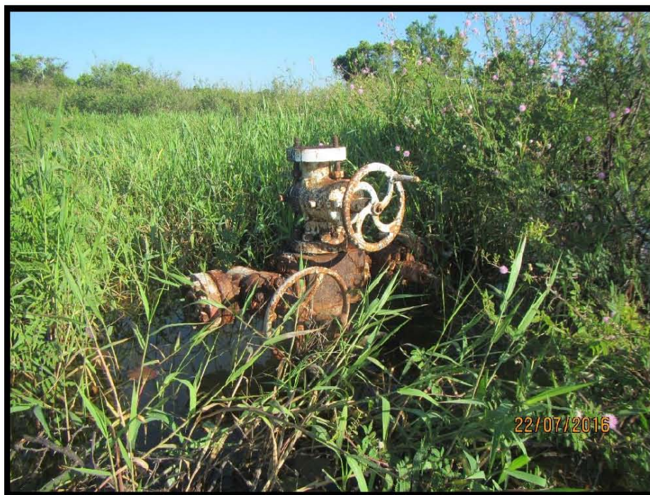
Fotografía 8.1.3.1-15. -Plataforma del pozo cubierta de malezas y anegado.
